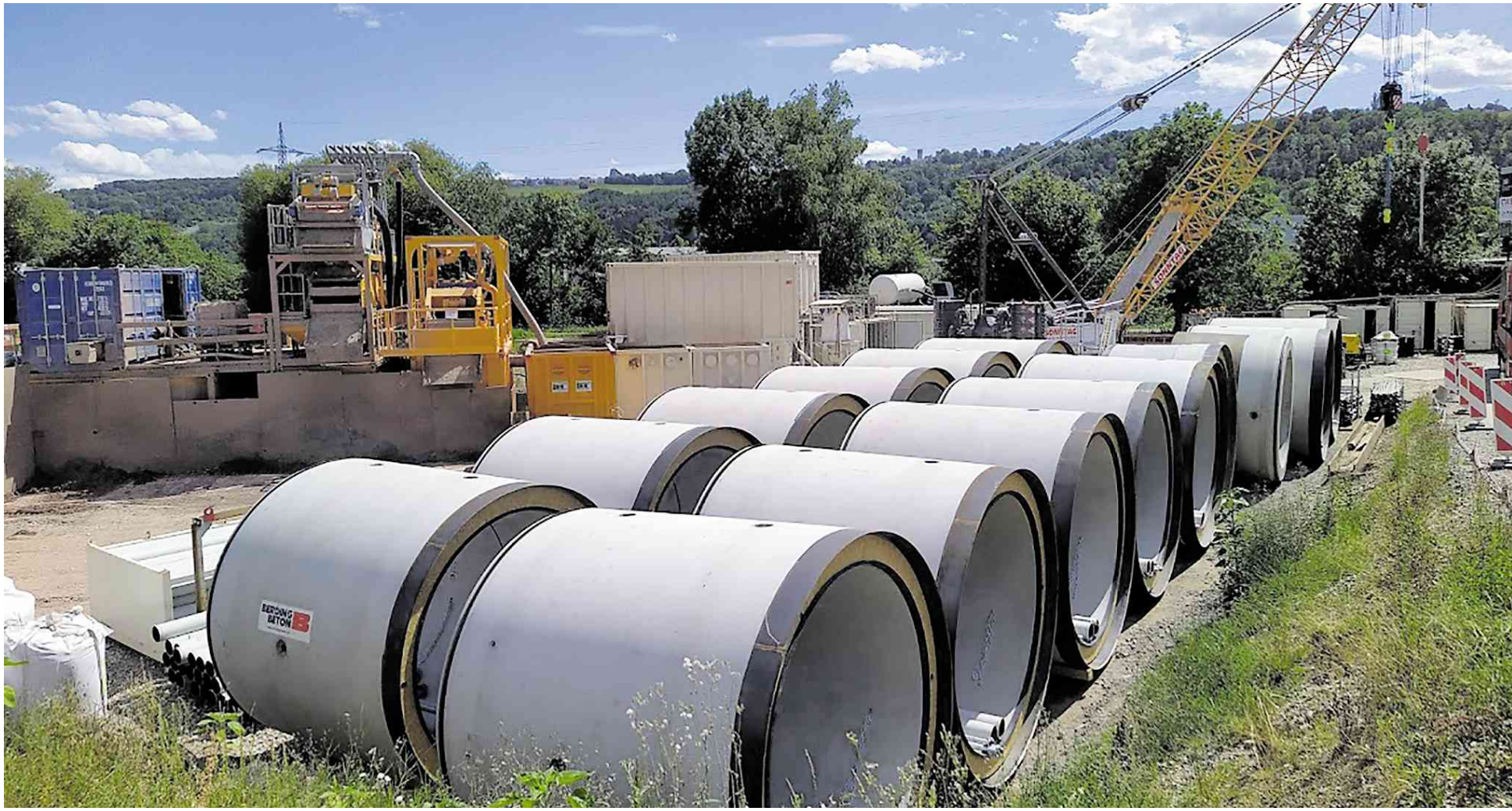
Aus diesen Stahlbetonrohren wird in den kommenden Wochen der Tunnel unter dem Fluss zusammen montiert.
