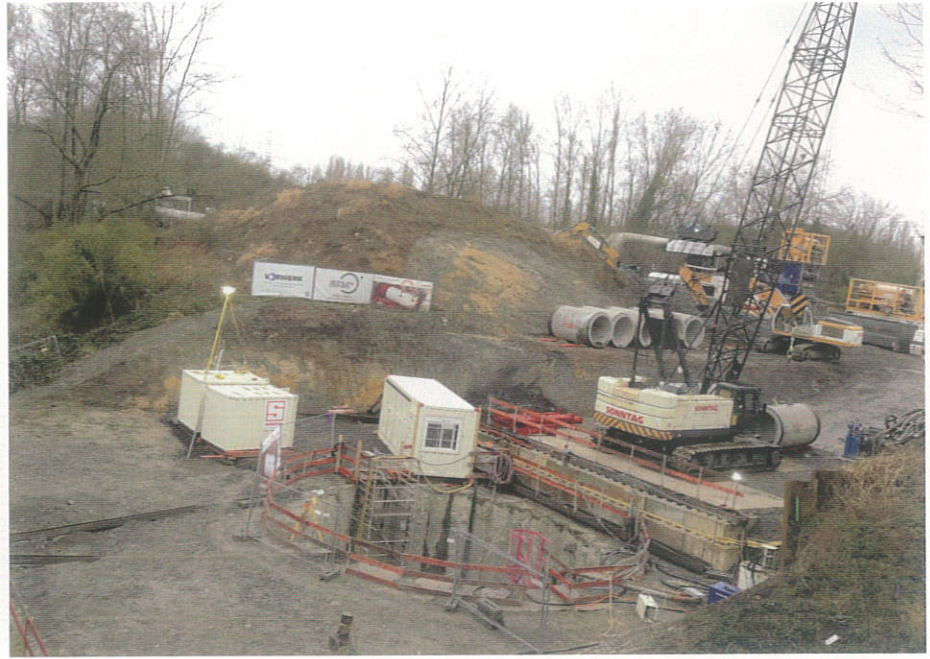
Hergestellte Startbaugrube mittels Bohrfahrverbaus vor Aufnahme des Vortriebs | Foto: De la Motte & Partner GmbH
