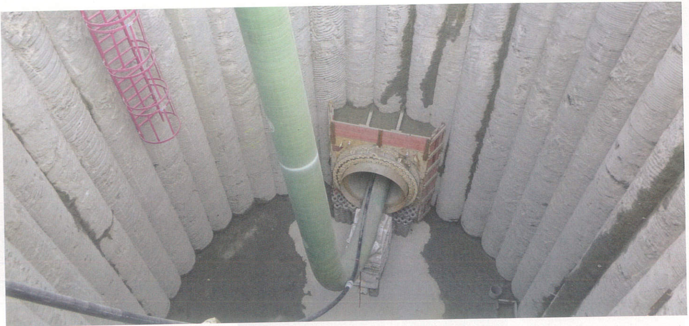
Beginn des Verdämmerns aus der Startbaugrube heraus | Foto: De la Motte & Partner GmbH
