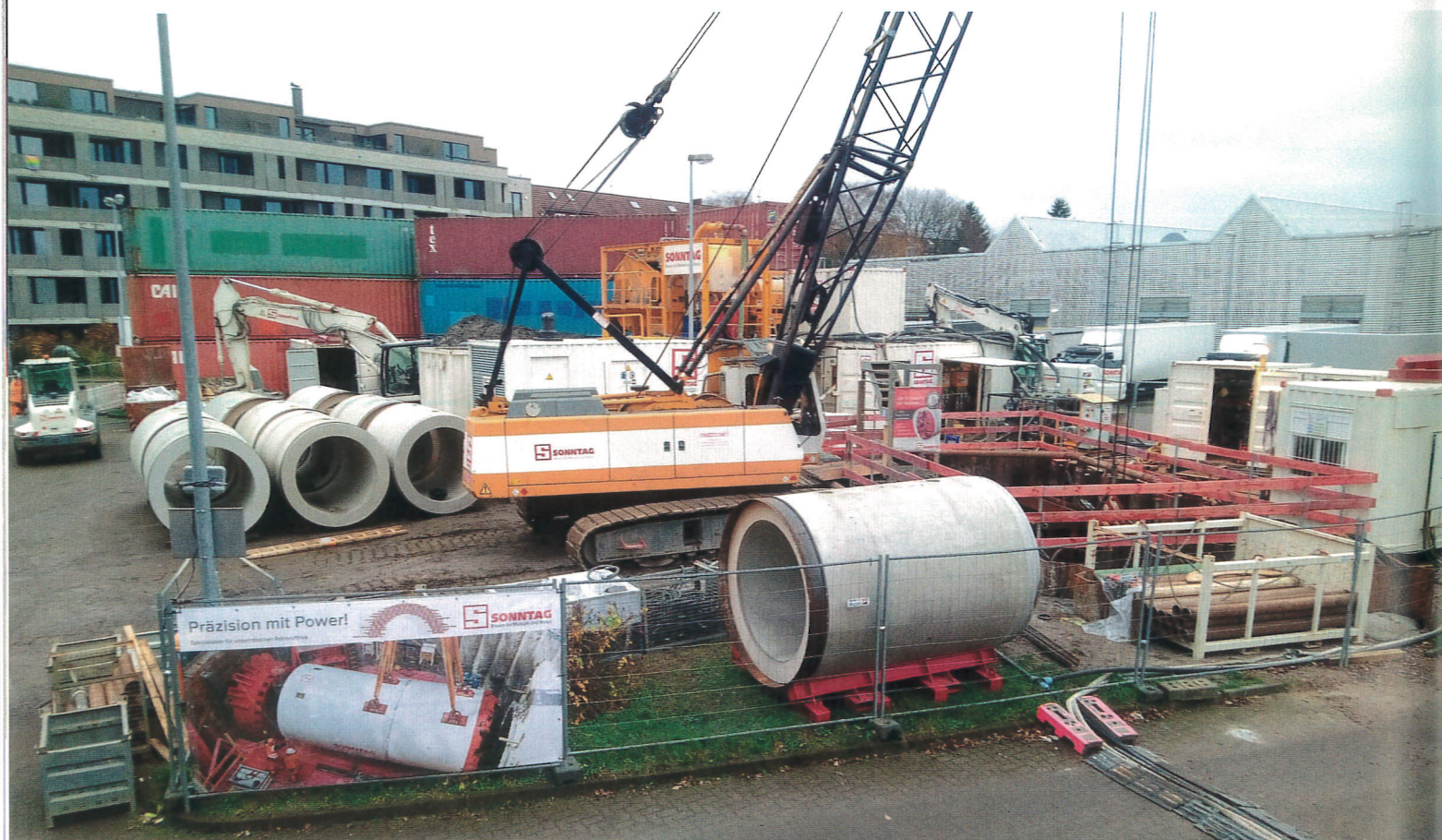
Abb. 4: Überblick über die Vortriebsbaustelle, im Bildhintergrund: Lärmschutzwand aus gestapelten Überseecontainern vor der angrenzenden Wohnbebauung
