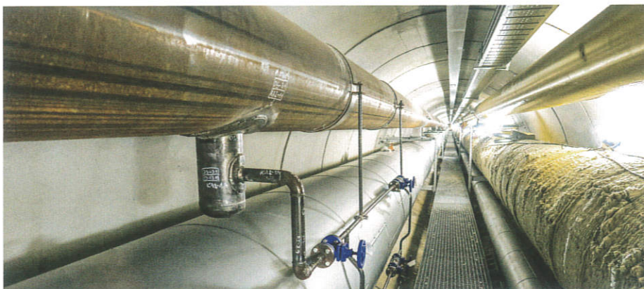
Ausbau und Wartung von Leitungen sind in diesem Kanal komfortabel möglich.
