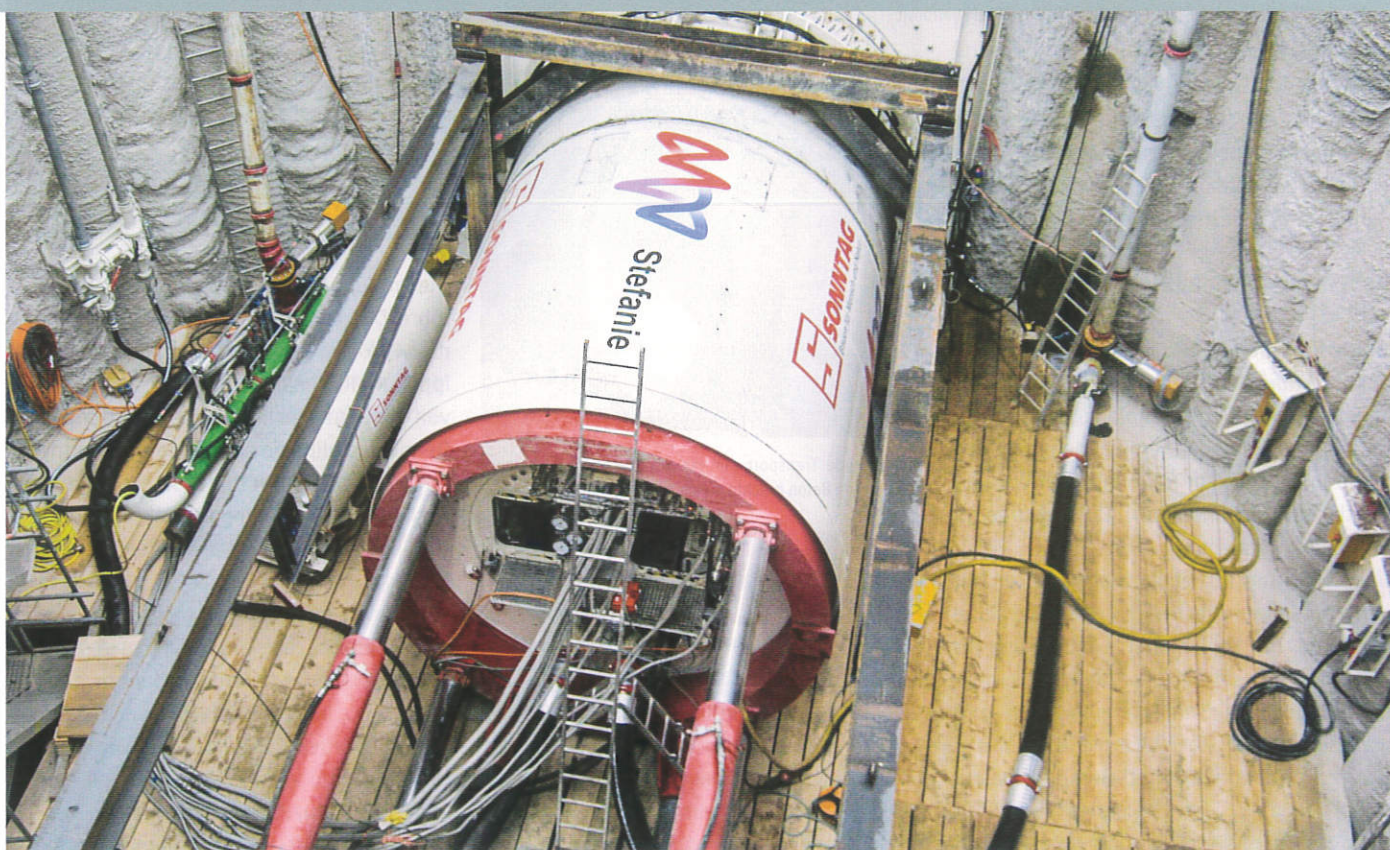
Die Vortriebsmaschine „Stefanie“ arbeitete sich in bis zu 20 Meter Tiefe unterhalb des Altrheins hindurch.
