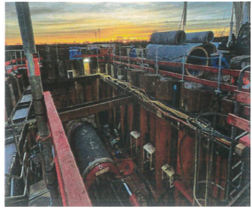
Die Tunnelbohrmaschine, die nun in Kehl zum Einsatz kam, fraß einen Tunnel mit rund 1,40 Meter Durchmesser durch das Erdreich unterhalb der B28.
