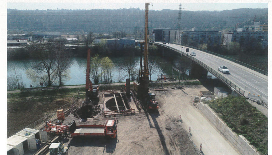
Parallelarbeit in Perfektion. Während die letzten Aushubbohrungen durchgeführt werden, kann der Hitachi ZX 350LC-6 TS mit Teledipper das lockere Material unter Wasser ausheben.
