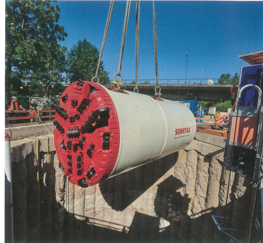
Der 95 to schwere Bohrkopf wird in die Startgrube gehoben. | Fotos: Sonntag Baugesellschaft
